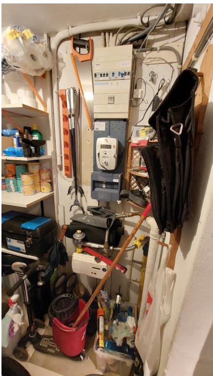
Figuur 18 Meterkast met gas- en elektriciteitsaansluiting
