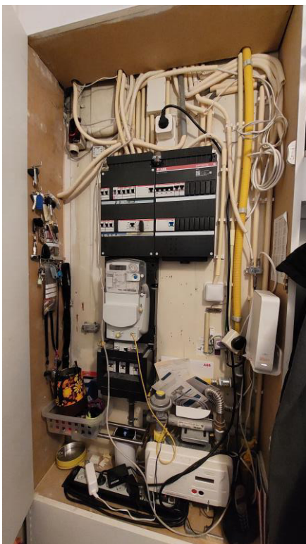
Figuur 26 Meterkast met gas- en elektriciteitsaansluiting
