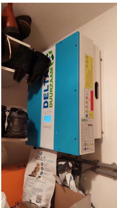
Figuur 27 Omvormer van de zonnepanelen
