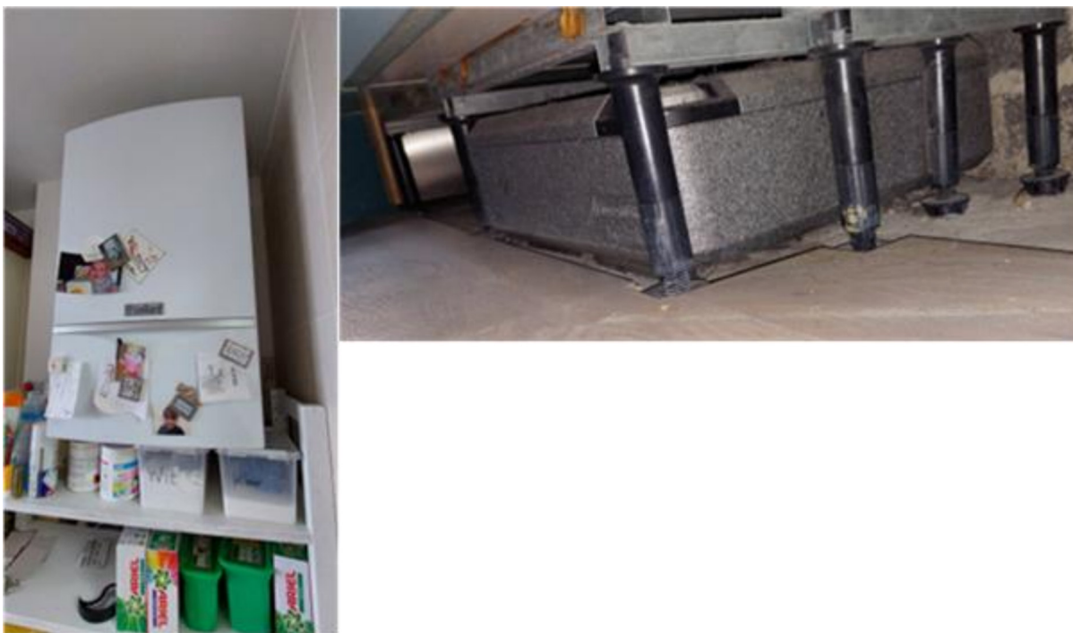
Figuur 8 Cv-ketel op de bovenste verdieping en keukenboiler onder het keukenkastje
