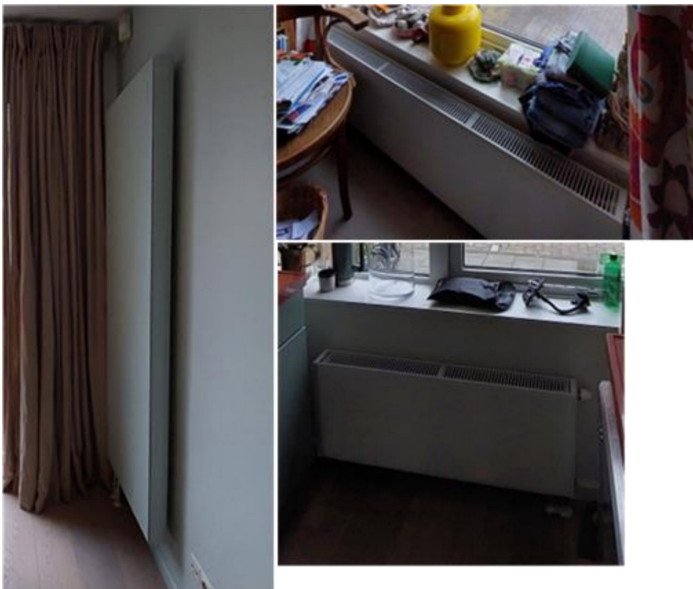
Figuur 9 Radiatoren in de woning
