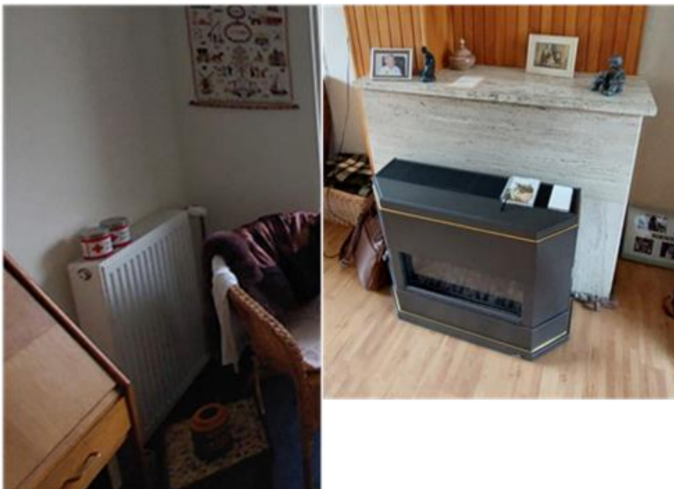
Figuur 4 Radiator op de bovenverdieping en gashaard in de woonkamer
