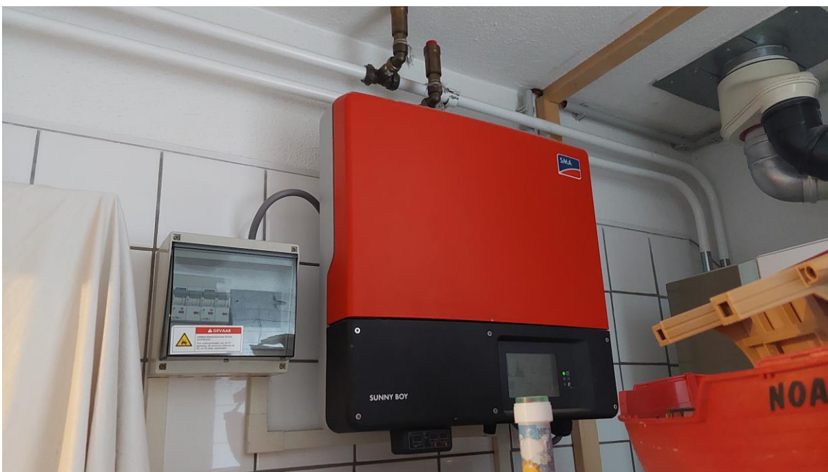
Figuur 19 Omvormer van de zonnepanelen
