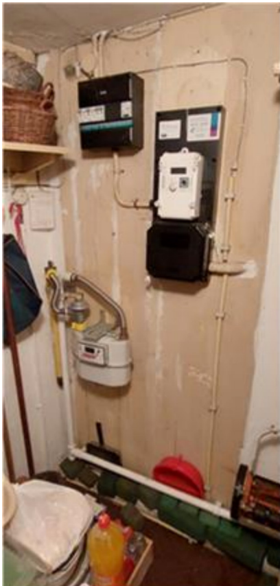
Figuur 6 Meterkast met gas- en elektriciteitsaansluiting
