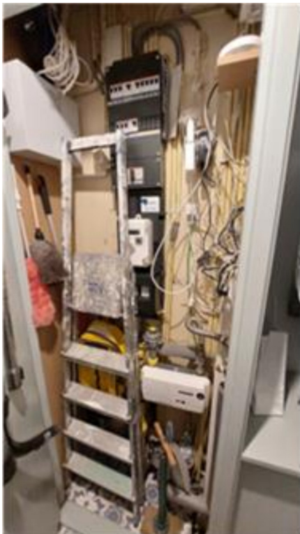
Figuur 12 Meterkast met gas- en elektriciteitsaansluiting
